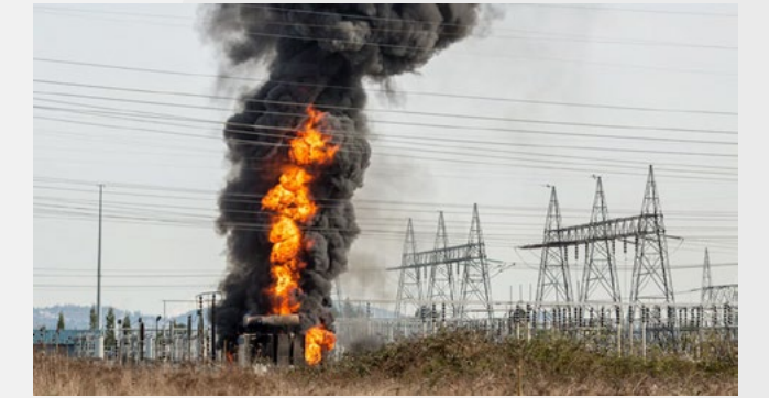
Şekil 3. Trafo patlaması sonucu oluşan bir yangın (Kaynak : T&D World)
