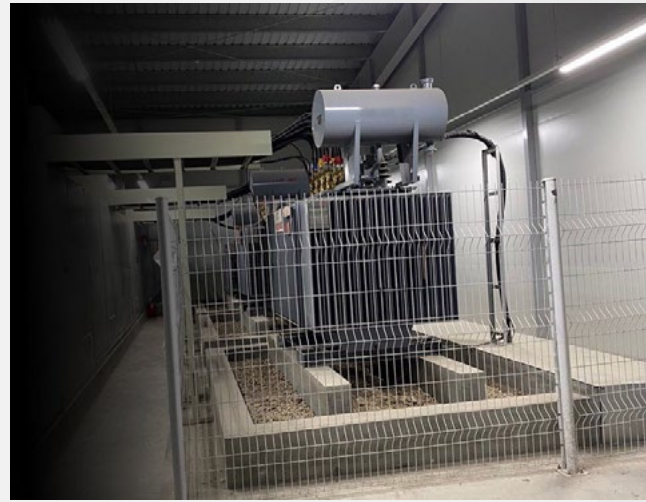
Şekil 1. Kapalı odadaki yağlı tip trafo (Kaynak : Ezgil)
